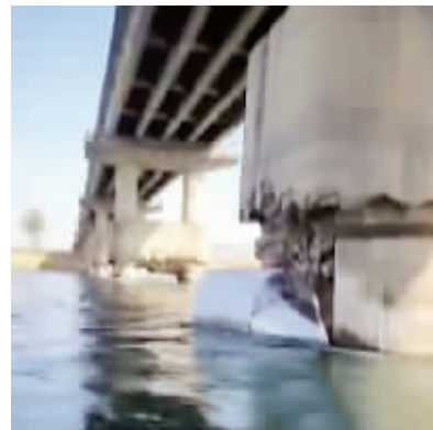
被困桥墩中间。
